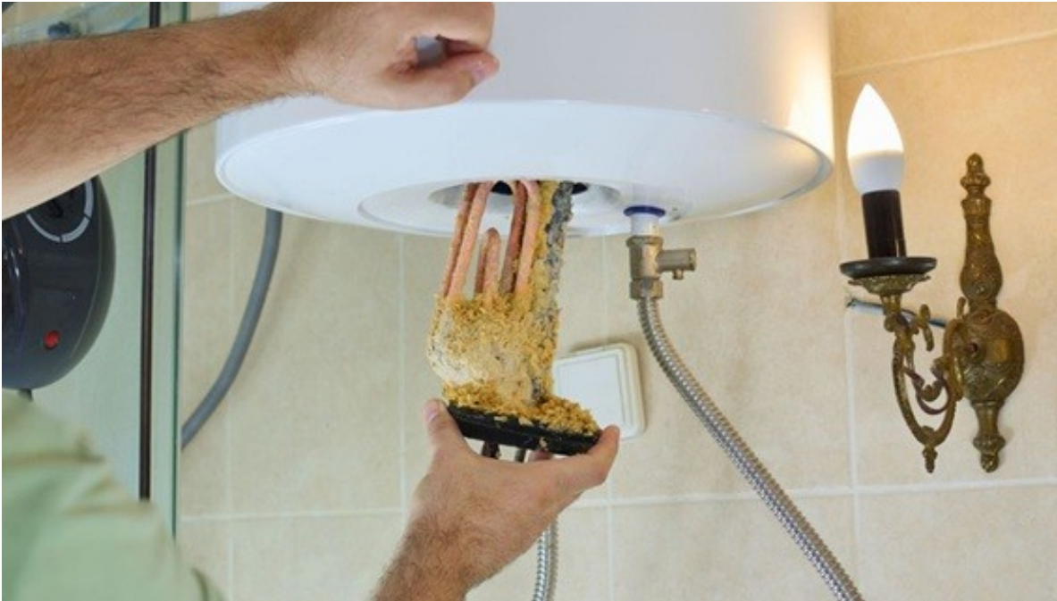
Extracción de una resistencia de termotanque con acumulación severa de sarro.
